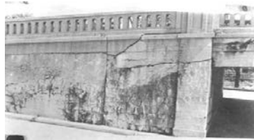
/б. Услед АСР на БМ у Канади [8]
