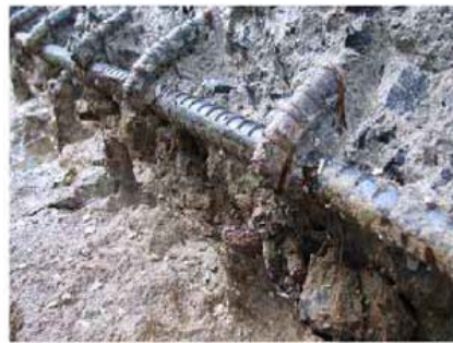
Слика 10/б. Лом арматуре на стубу БМ у Јапану, 2008.г., [8]
