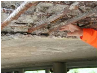
Слика 10/а. Деламинација заштитног слоја бетона коловозне плоче БМ, [19]
