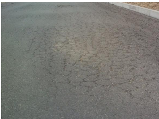
Слика 2 – Мрежасте пукотине, испуцала површина коловоза
