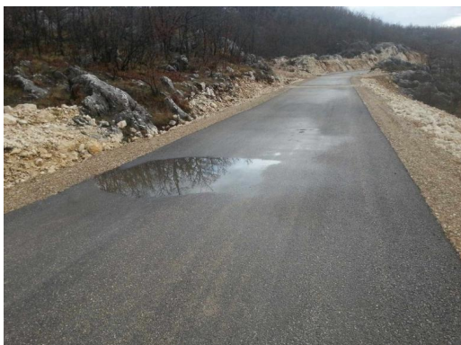
Слика 4 – Изглед коловоза, дефлексија, задржавање воде на коловозној површини
