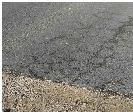
Слика 3 – Испуцала површина коловоза
