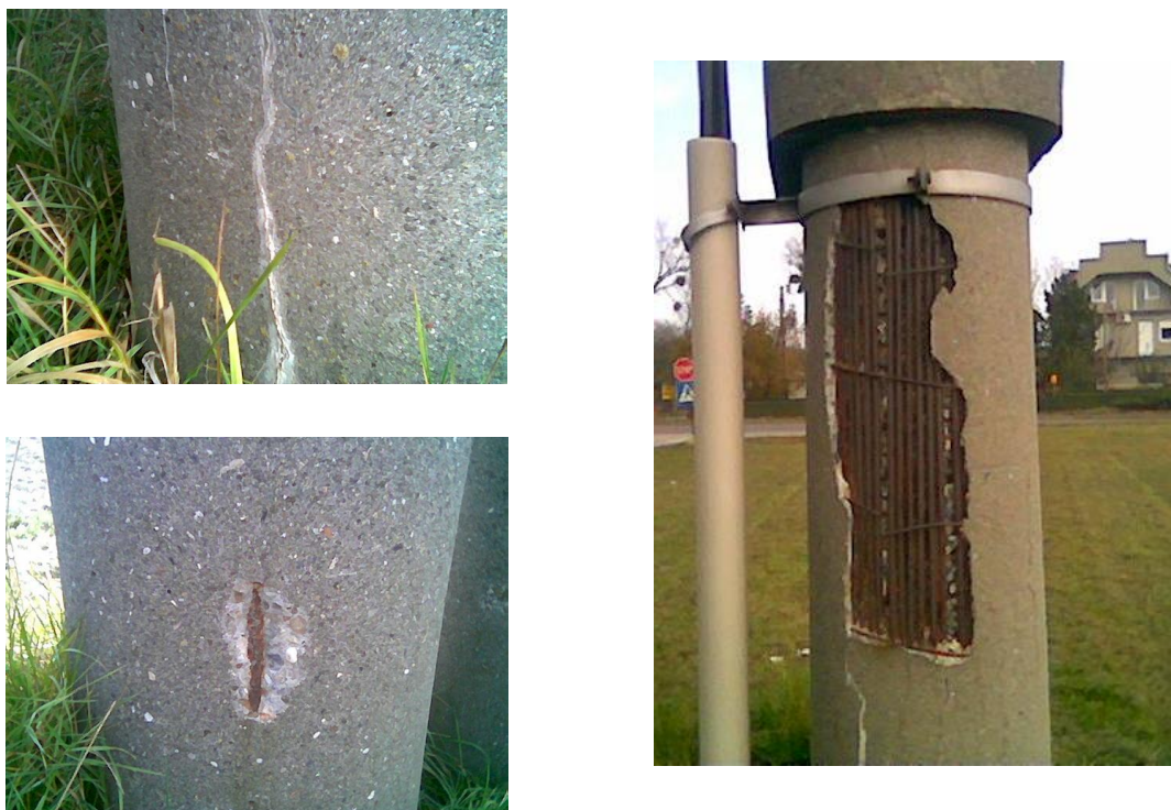
Slika 45. Prsline usled degradacije materijala (korozije armature)
