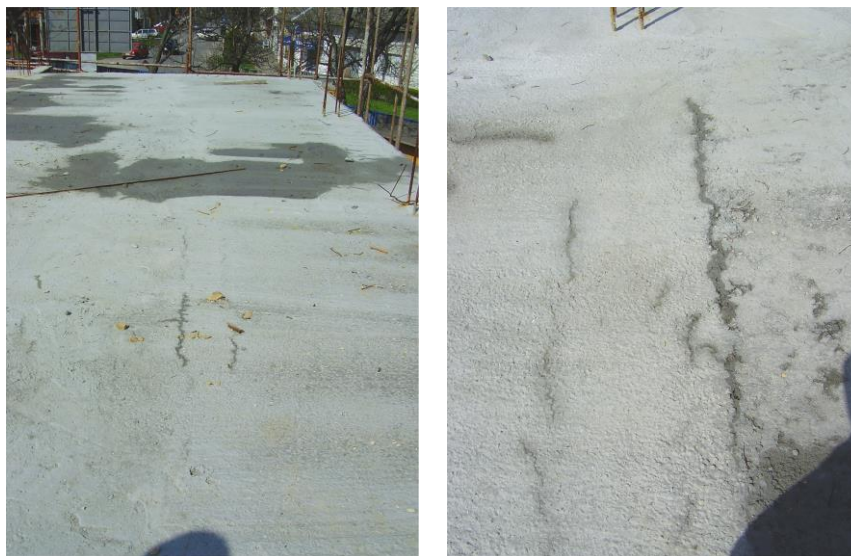
Slika 37. Prsline usled plastičnog sleganja na spoju FERT međuspratne ploče i podvlake
