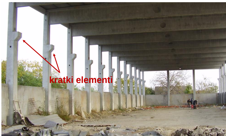
Slika 126. Kratki elementi kao oslonci nosača kranske staze u industrijskoj hali
