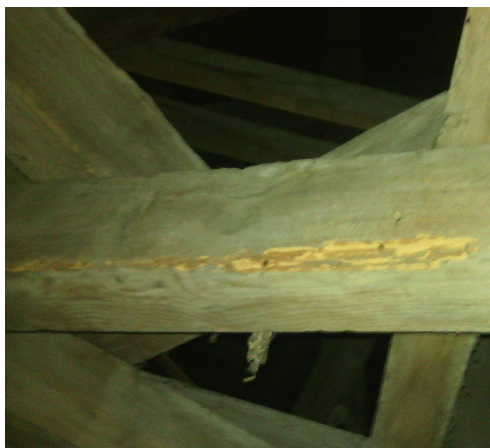
Слика 4. Оштећење дрвених елемената услед црвоточина
