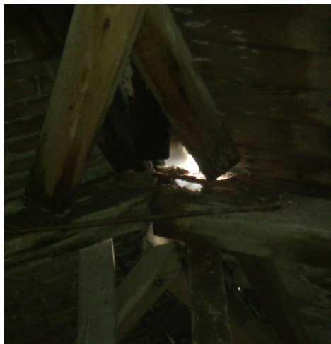
Слика 4. Оштећење дрвених елемената услед прокишњавања
